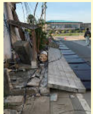
熊本地震での被災事例
