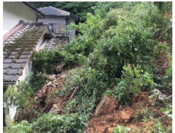
人家隣接の斜面が崩落（令和2年 長崎市）
