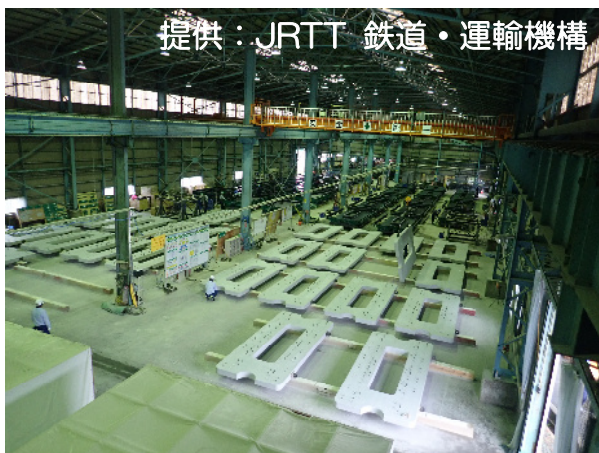
大村・長崎間軌道スラブ製作運搬工事 (工場での製作状況)
