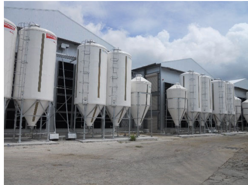
畜産クラスター事業を活用して建設された鶏舎
