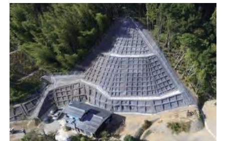
がけ崩れ対策施設(佐世保市)
