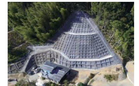
がけ崩れ対策施設(佐世保市)
