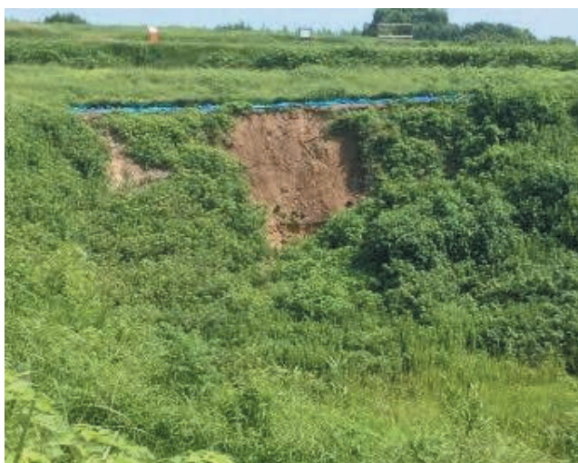
大雨で法面が崩落した原城跡
