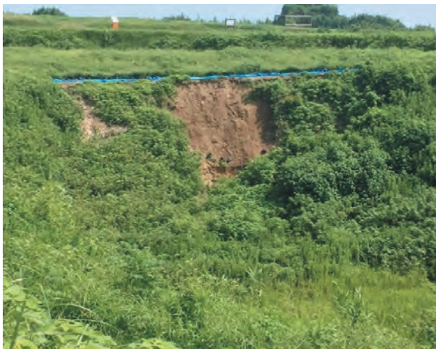
大雨で法面が崩落した原城跡
