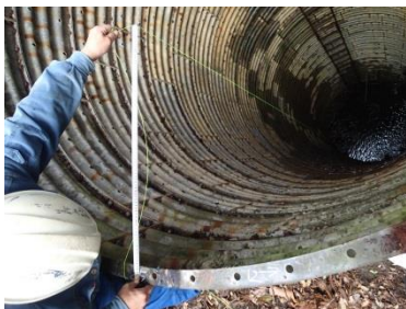
既設集水井戸の傾き
