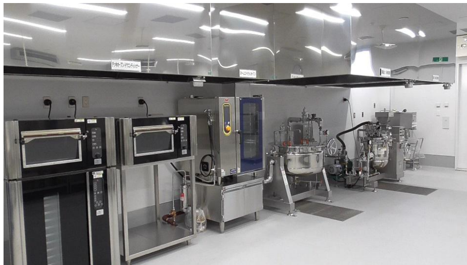
二次加工室の設備
