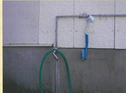
畜舎入口に洗浄設備・消毒薬設置
