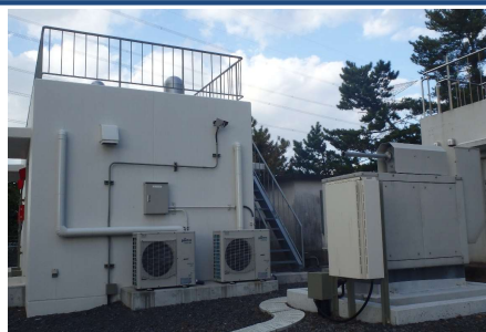
モニタリングステーションと 非常用発電機
