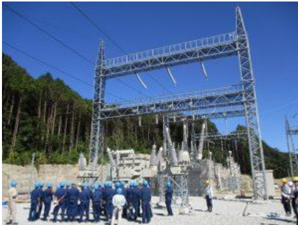
【新諫早変電所での見学の様子】
