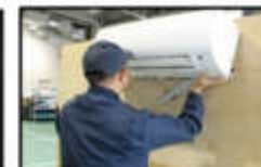
▲ 冷暖配管の施工と空調機器据付け技術
