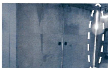
出入口扉の隙間
