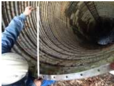
既設集水井戸の傾き
