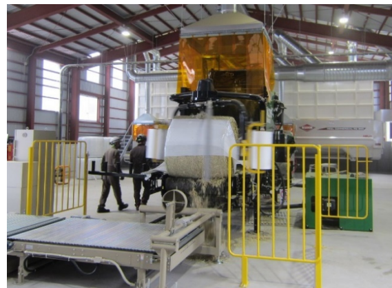
畜産クラスター事業を活用して整備された飼料調製施設
