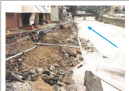
長崎大水害 (S57.7.23) の被災状況
