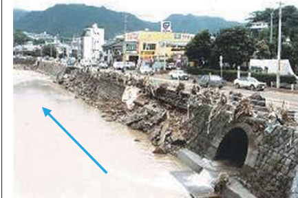
長崎大水害 (S57.7.23) の被災状況
