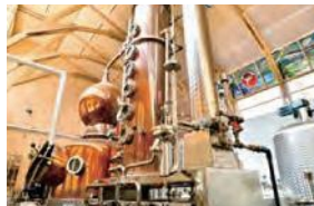
クラフトジン蒸留装置
