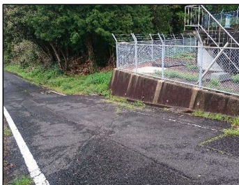
①配水池前市道のヒビ
