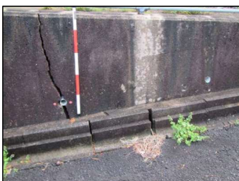
②配水池擁壁のヒビ
