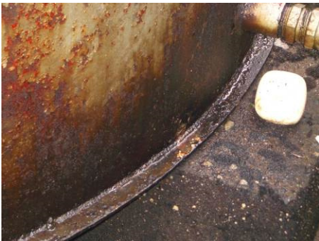
・ 重油タンクの腐食
