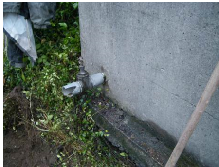
・ 防油堤のひび割れとバルブ
