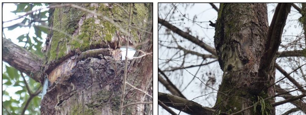
図 6.2 樹体保護のリング設置箇所の腐朽状況
