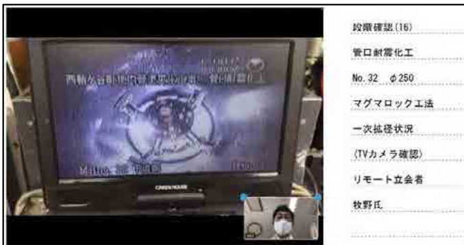
【立会状況画面（現場側）】
