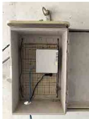
【坑内にWi-Fiルーターの設置(@100m)】
