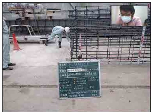
【立会状況画面（現場側）】
