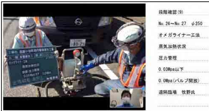
【立会状況画面（現場側）】
