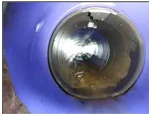
【オンライン検査（管の通り確認）】
