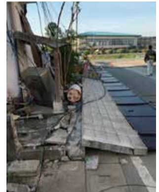
熊本地震での被災事例
