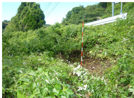
法面崩壊(盛土)
