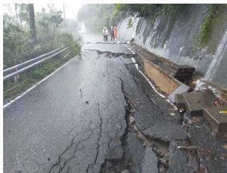
落石・崩壊((主)野母崎宿線 R3.8 発生)
