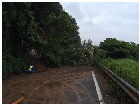
落石・崩壊((国)251号 H28.6 発生)
