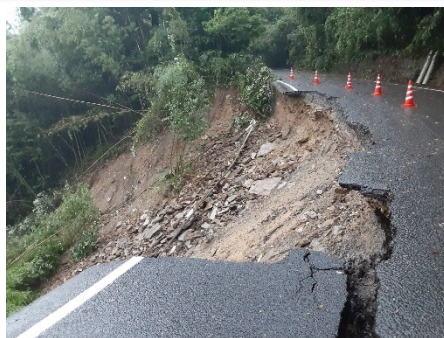
落石・崩壊((一)扇山公園線 R3.8 発生)
