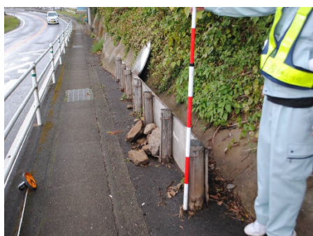
のり尻部の小落石(兆候)
