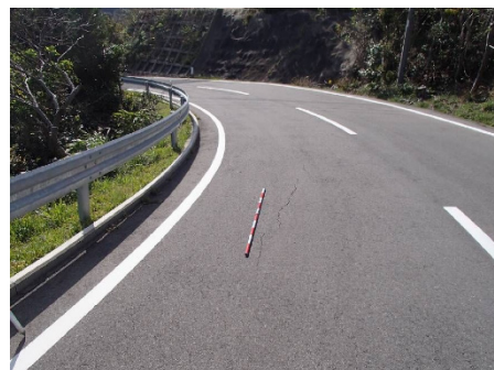
舗装のクラック
