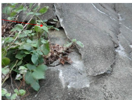
吹付面上のクラック
