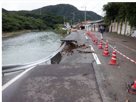
擁壁(崩壊)((主)棧原小茂田線 R1.9 発生)
