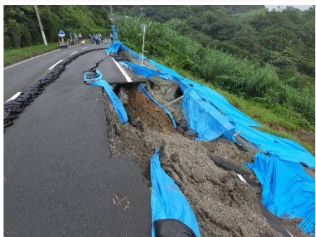
落石・崩壊((国)202号 R3.8 発生)
