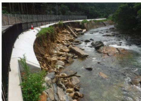
擁壁(崩壊)((一)玉之浦岐宿線 R1.7 発生)
