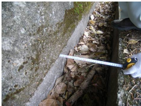
排水路工への土砂等の堆積の例 (主要地方道愛野島原線)
