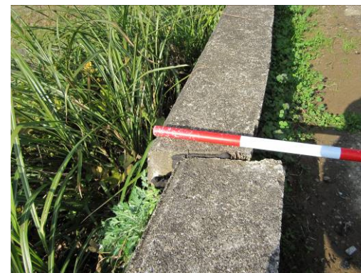
擁壁背面のズレ・段差の例 (一般国道 389 号)
