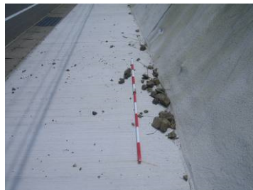
のり尻の転石の例 (一般国道 444 号)
