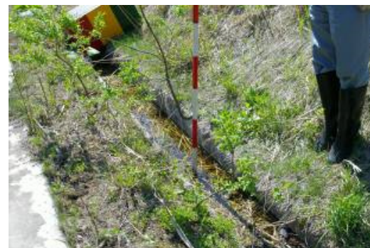
路面排水の機能低下の例 (土砂による閉塞)
