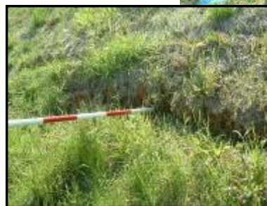
斜面の段差・亀裂の例
