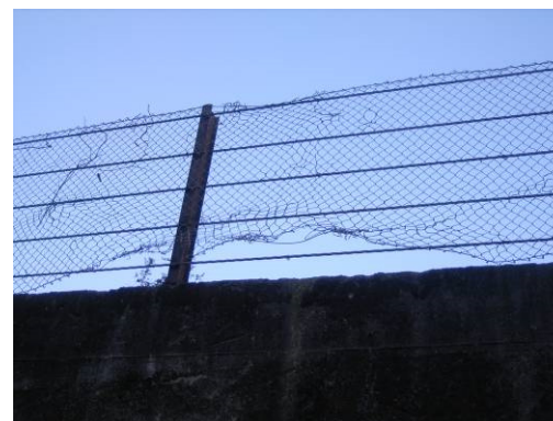
落石対策工(落石防護柵)の変形、破損の例 (一般国道 251 号)
