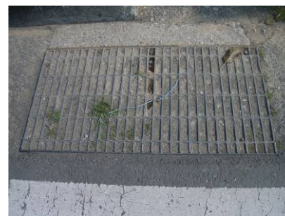
擁壁下排水施設の目詰まりの例 (一般国道 251 号)
