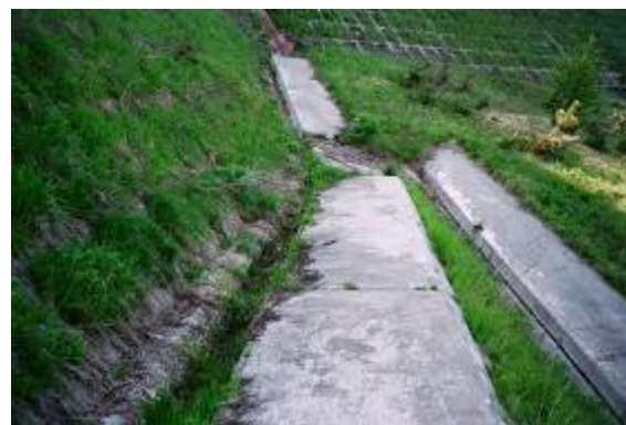
水路の排水機能の低下の例（土砂の堆積）
