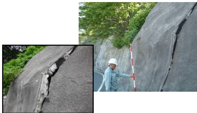
モルタル吹付工の剥離（座屈）の例
