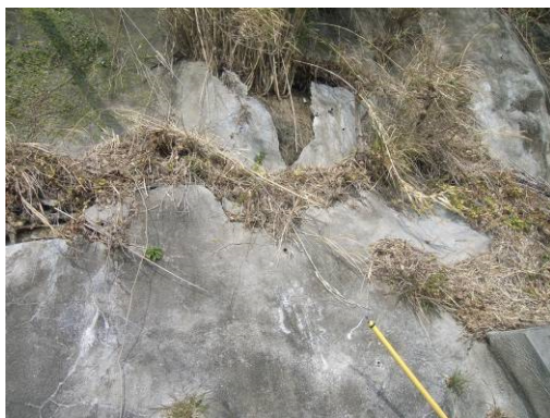
モルタル吹付工の剥離の例 (一般国道 251 号)
