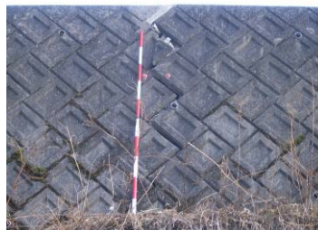
擁壁の亀裂の例 (一般国道 251 号)
