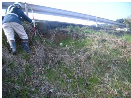
のり面のはらみ出し／ずり落ちの例 (一般国道 251 号)
