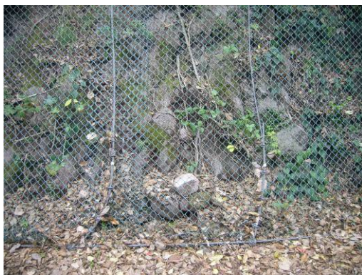
落石防護網内への土砂の堆積の例 (一般県道北野千々石線)
