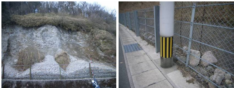
落石防護柵背後の落石の例 (一般国道 389 号)
