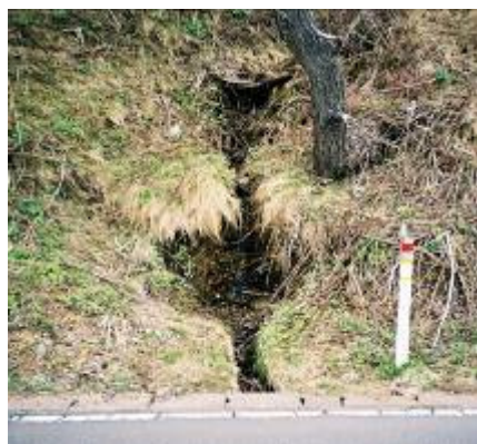
斜面のガリーの例
