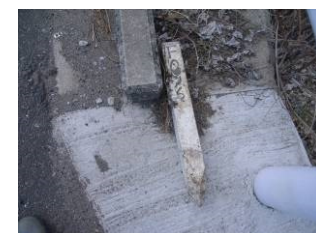
対象箇所から抜け落ちた杭
