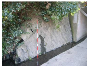
擁壁の亀裂からの湧水の例 (一般国道 251 号)
