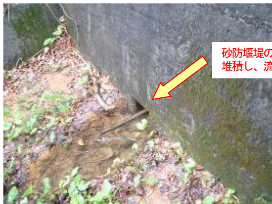
溪床への土砂の堆積の例
