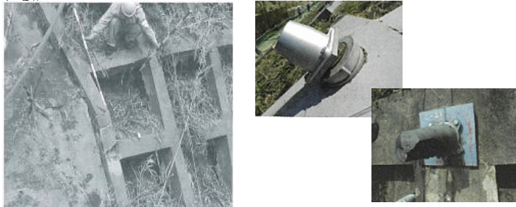
のり枠工の押出し変状の例/アンカー工破損の例
