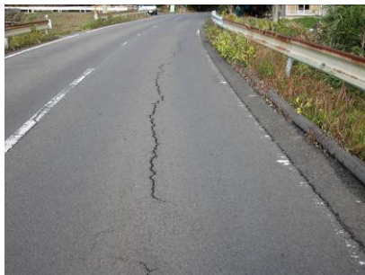
路面の亀裂の例 (一般国道 389 号)
