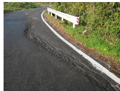
路面の亀裂および陥没の例 (一般県道山口南有馬線)
