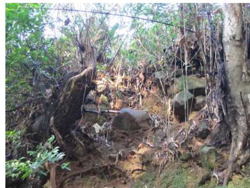
斜面・のり面上の不安定な転石の例 (一般県道平石千々石線)
