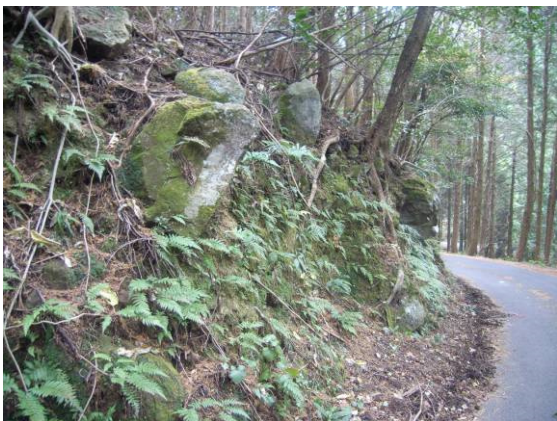
斜面露岩部上の不安定な浮石の例 (一般県道平石千々石線)
