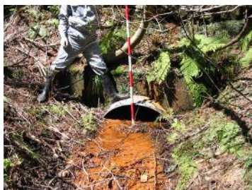
横断排水の機能の低下の例 (土砂による閉塞)
