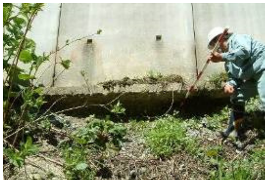
擁壁前面の地盤の洗掘の例
