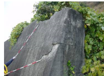
擁壁の亀裂の例 (一般国道 251 号)
