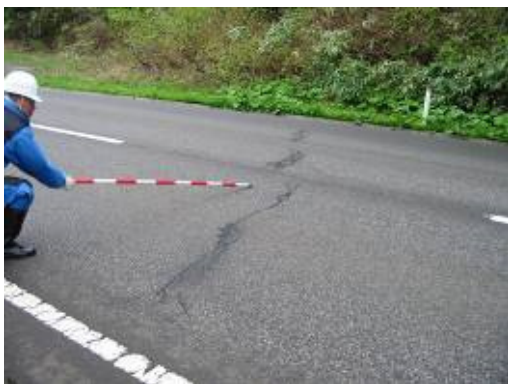
路面の亀裂の例
