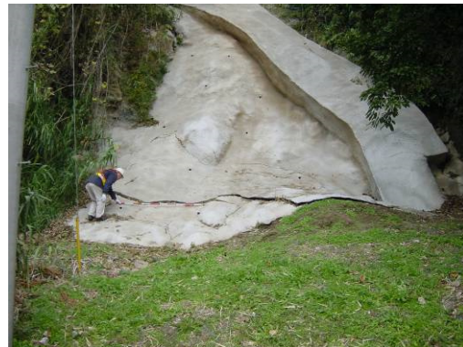
モルタル吹付工の亀裂の例 (一般国道 251 号)
