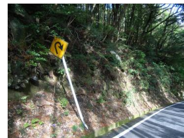
傾倒した斜面下の標識の例 (一般県道雲仙千々石線)
