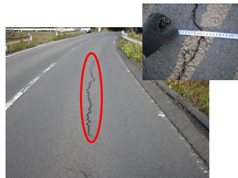
路面の亀裂の例 (一般国道389号)
