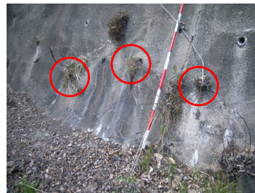
水抜孔の排水機能の低下の例〔植生の繁茂〕 (主要地方道小浜北有馬線)
