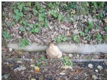
のり尻の転石の例 (主要地方道愛野島原線)
