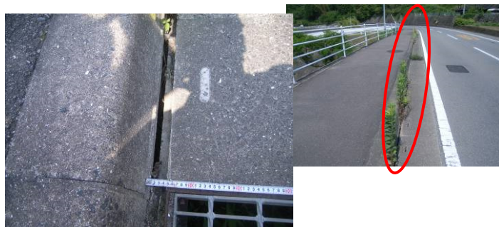
排水路工の変状の例 (一般国道 444 号)
