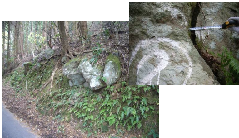
露岩部の亀裂及び定点観測の例 (一般県道平石千々石線)
