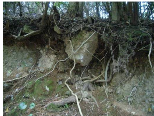
斜面露岩部のオーバーハング化の例 (一般県道平石千々石線)
