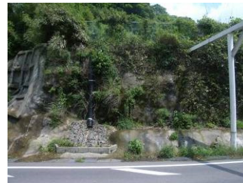
斜面からの湧水の例 (一般国道 444 号)
