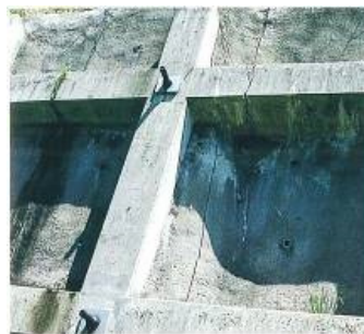
のり砕工の亀裂の例
