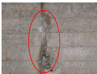
写真 3.3 本体工の変状事例 うき・はく離 【判定区分：B】
