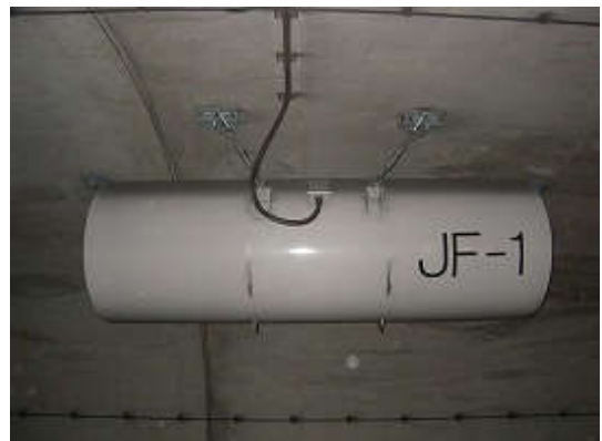
換気施設 (ジェットファン)
