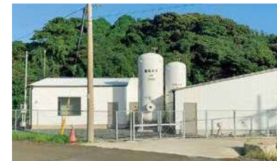
RE水素システム施設外観(提供:杵岐市)
