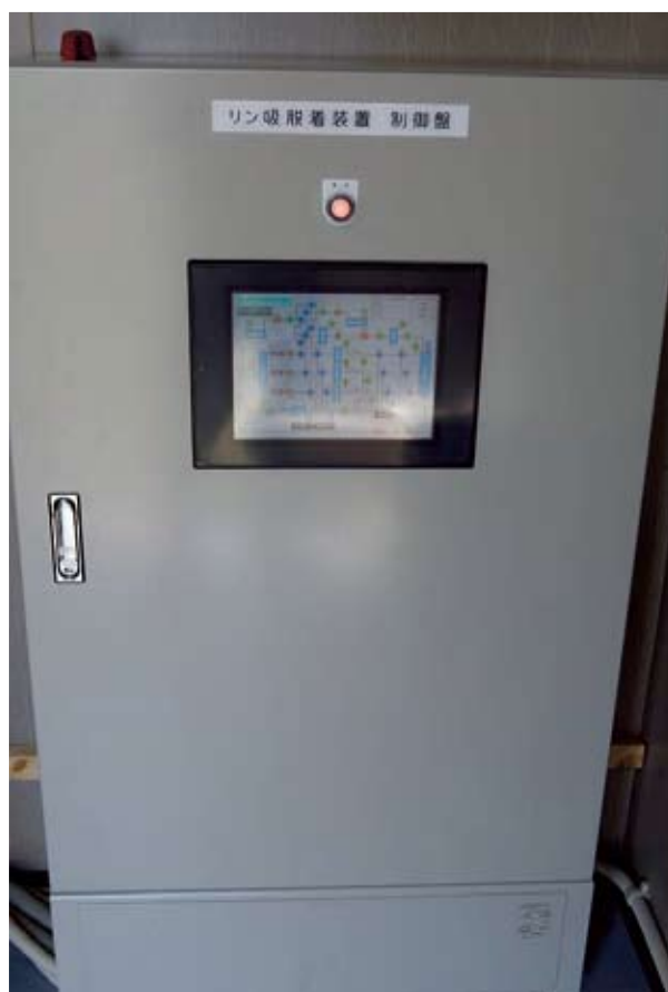
図7 リン吸脱着システムの制御盤
