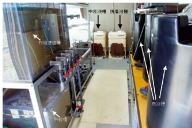
図3 リン吸脱着システム外観(全体)
