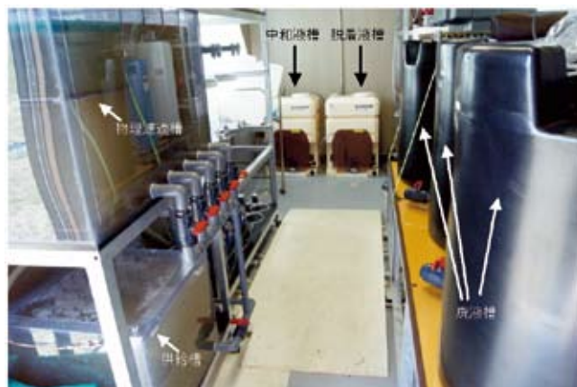
図3 リン吸脱着システム外観(全体)
